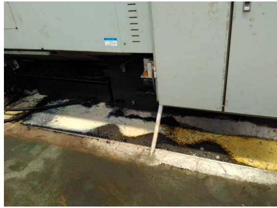
车床：水泥地面安放宽体油盆，车床切削液及废机油不渗漏、外溢
