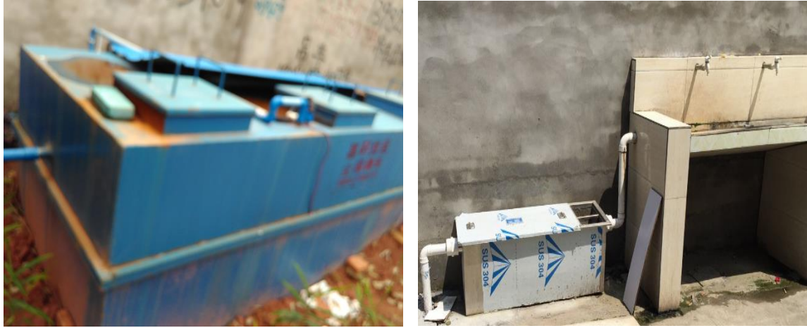
图 3-2 园区一体化污水处理设施及隔油池
