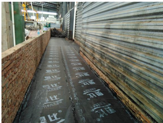
铁屑暂存区：水泥结构地面并涂覆2mm厚高密度聚乙烯防渗材料
