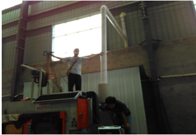
图 3-1 喷丸布袋除尘器及排气筒
